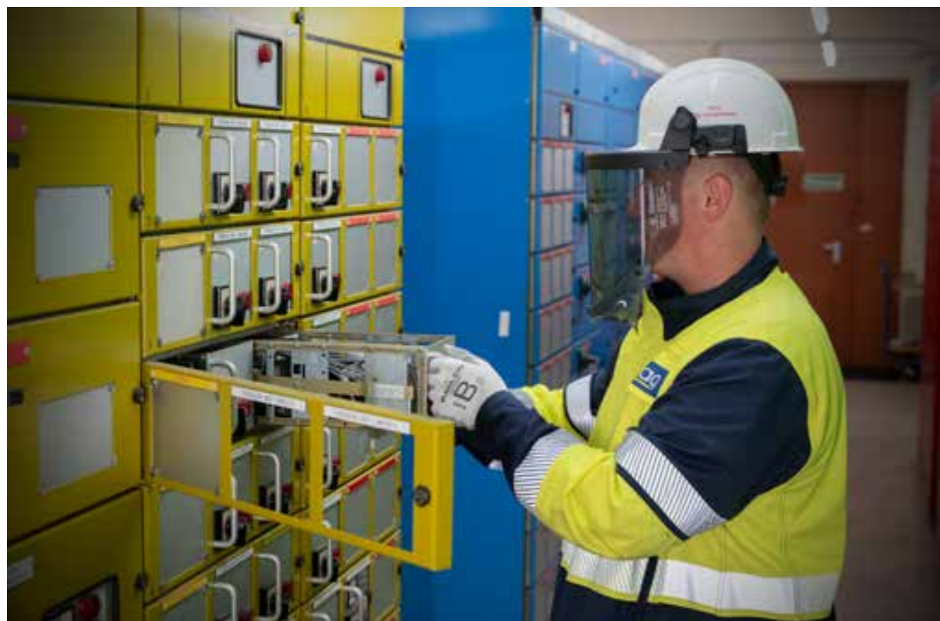
Maurice Klein entfernt in der Schaltanlage des HKV die Sicherungen eines Antriebs.
